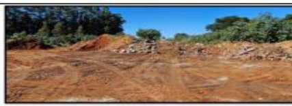
Foto 6 – Acúmulo de resíduos da construção civil. Houve uma diminuição no volume, possivelmente aplicado em alguma estrada rural.
