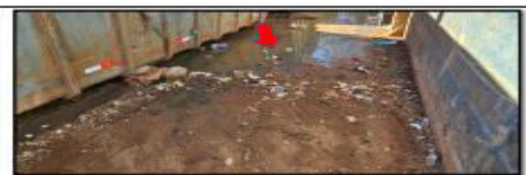
Foto 4 – Limpeza dos resíduos precisa ser executada, contém água parada no local, demonstrando a necessidade do encanilhamento correto das águas pluviais.
