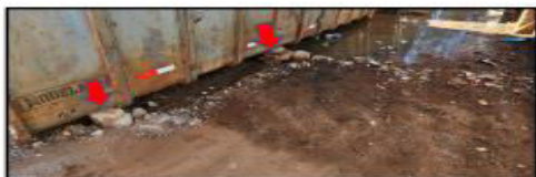
Foto 5 – Limpeza dos resíduos precisa ser executada, contém água parada no local, demonstrando a necessidade do encanilhamento correto das águas pluviais. Detalhe para a escora da caixa, que pode classificar a estrutura da mesma e gerar projetos ao município.
